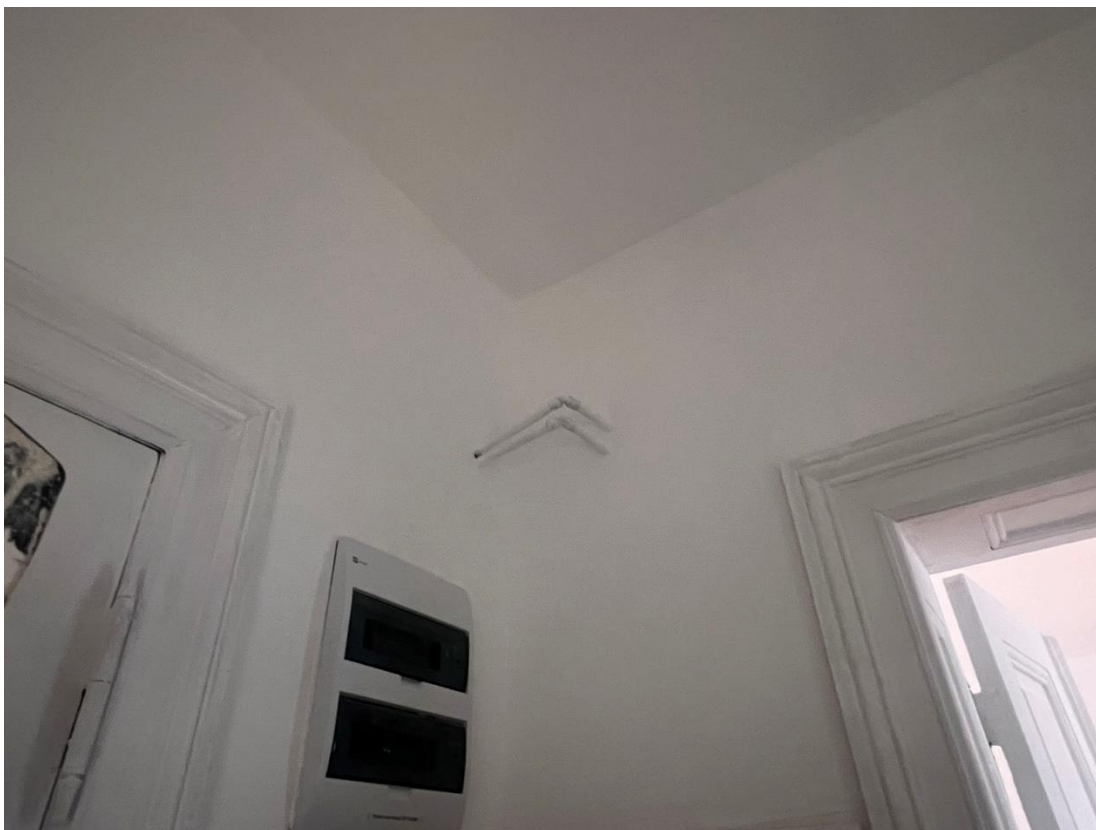
Fot. 14. Instalacja centralnego ogrzewania – sposób wykonania
