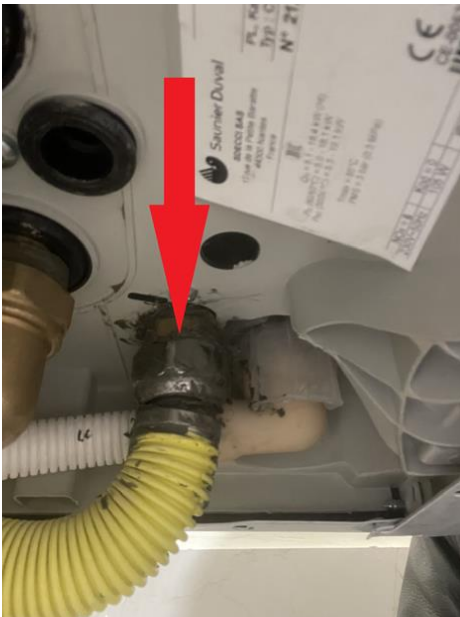
Fot.28. Nieszczelne połączenie przewodu gazowego z kotłem
