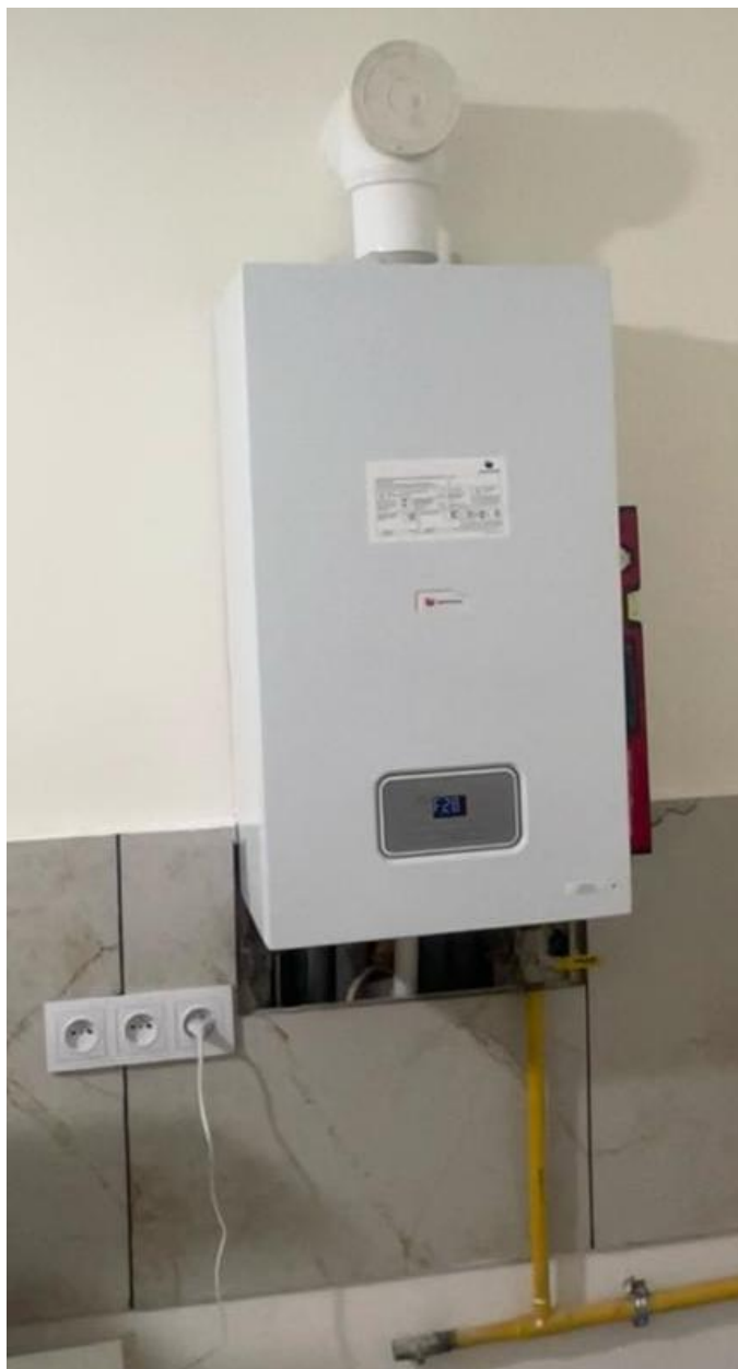
Fot.29. Krzywo zawieszony kocioł gazowy
