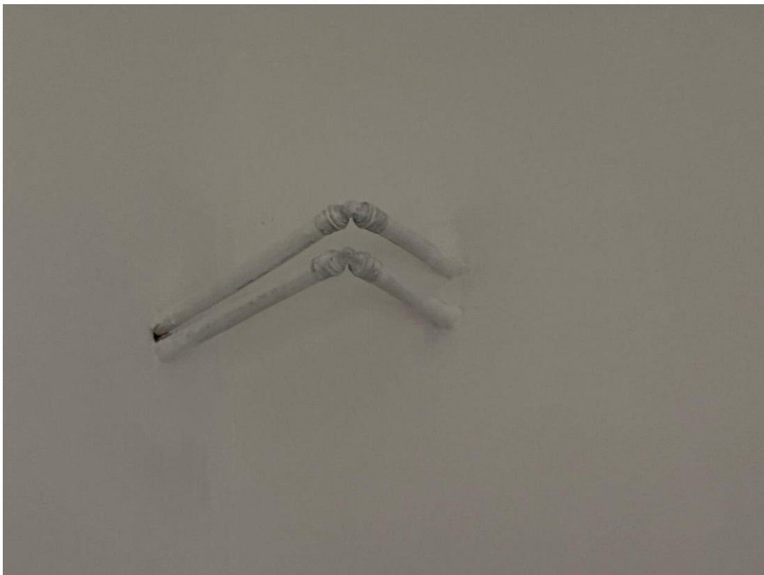
Fot. 13. Instalacja centralnego ogrzewania – sposób wykonania
